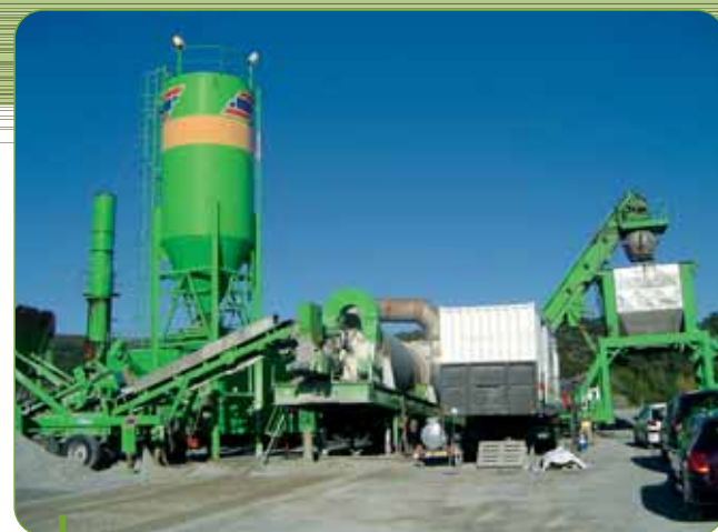
Un laboratoire mobile installé près du poste d’enrobage assurait le contrôle qualité du bitume à la réception de chaque porteur.
