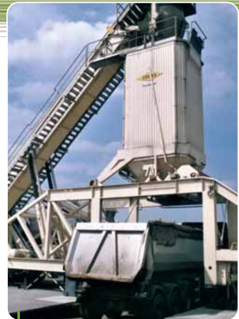
La centrale d'enrobage installée sur le site, d'une capacité de 400 t/h.
