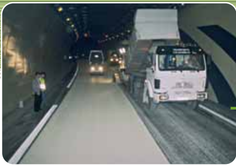
Pose d'enrobés clairs dans un tunnel de l'A08 du contournement de Nice : les mêmes souplesse et rapidité de mise en œuvre que les enrobés noirs.
