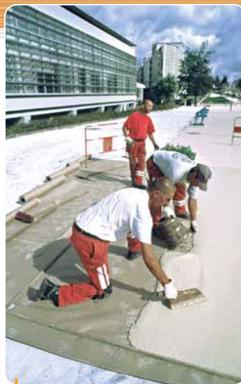
Application de 13 000 m 2 d'asphalte clair à partir de Shell Mexphalte C sur le campus universitaire de Nantes. L'asphalte est un matériau coulé et non compacté, facile à poser autour des nombreux obstacles rencontrés dans les aménagements urbains.
