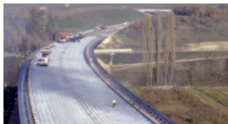
Un soin particulier a été apporté à l'étanchéité des ouvrages et au drainage des eaux de ruissellement.
