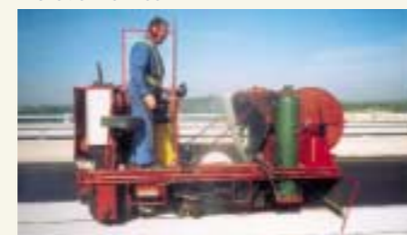
La machine, mise au point par l'entreprise Sacan, permet à ses deux opérateurs de réaliser la pose quotidienne de 1500 m 2 de feuilles d'étanchéité préfabriquées au bitume élastomère, de 150 m de longueur.
