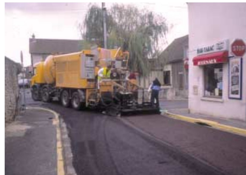
Mise en place d'ECF, un matériau parfaitement adapté aux interventions en voirie urbaine.
