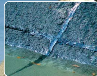
Les installations de traitement de l'eau à Marseille sont alimentées par un canal dont l'étanchéité comporte de nombreux joints bitumineux.
